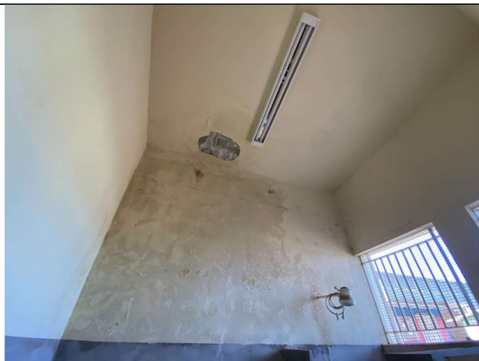
Foto 05 – Sinais de infiltração em paredes e teto do banheiro
