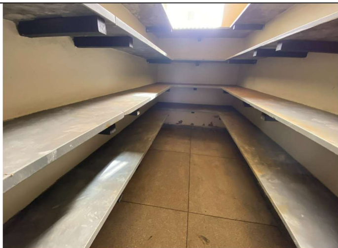
Foto 07 - Salas do administrativo com sinais de infiltração nas paredes
