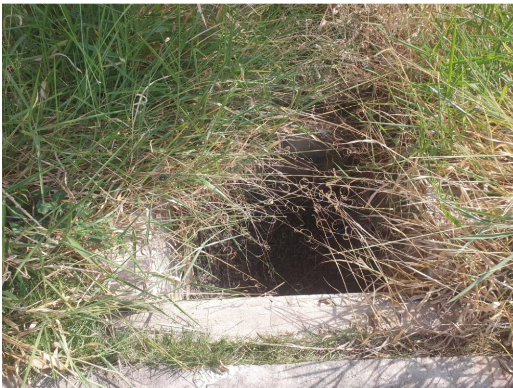
Imagem 7: caixa de passagem entre QGBT e quadros de distribuição.
