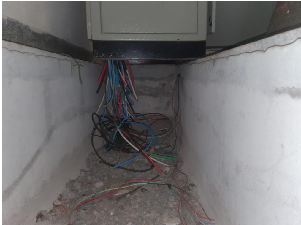
Imagem 5: fiação que sai do QGBT
