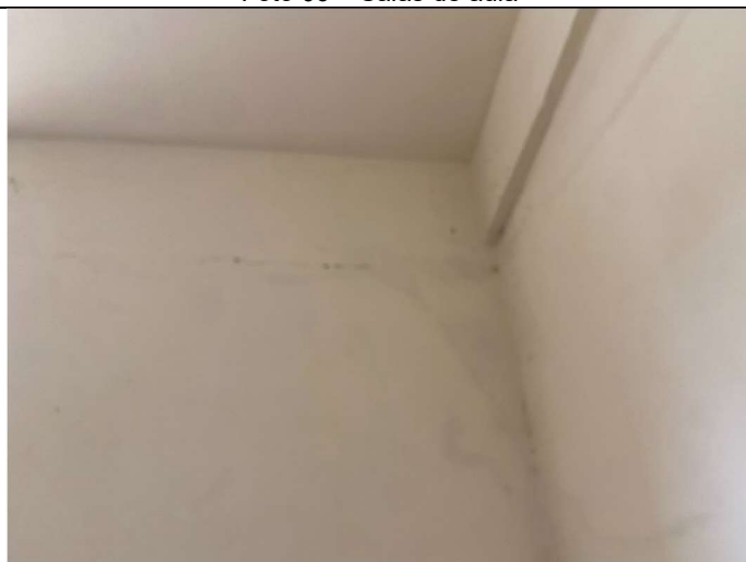
Foto 08 – Sinais de infiltração e manchas em parede de sala de apoio
