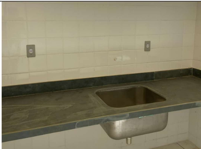
Foto 05 – Pia sem sifão e sem pia
