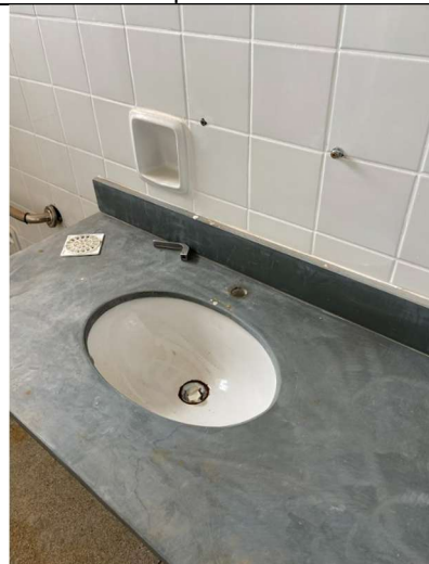
Foto 06 – Banheiro P.N.E sem torneira na pia
