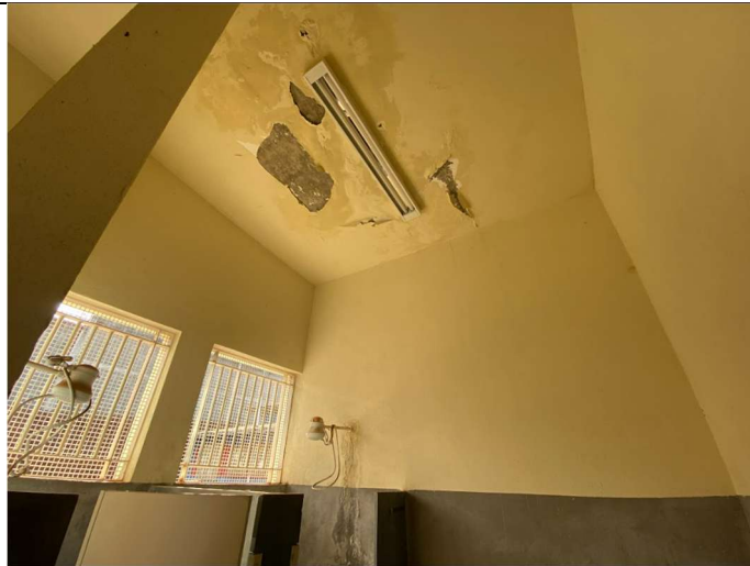
Foto 02 – Sinais de infiltração em teto em um dos banheiros do prédio
