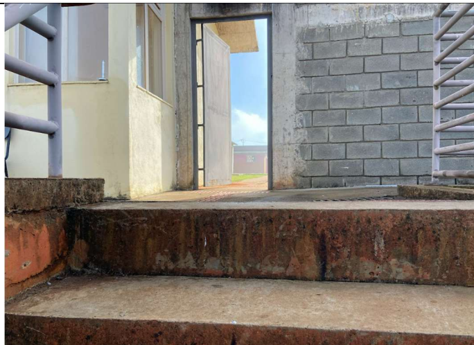
Foto 02 - Detalhamento de escada com possível recalque de solo do local
