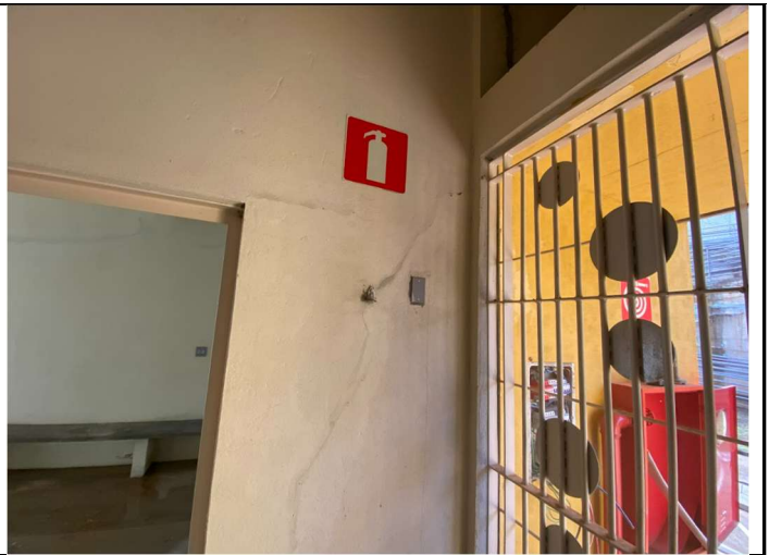
Foto 06 – Trinca aparente em corredor do bloco
