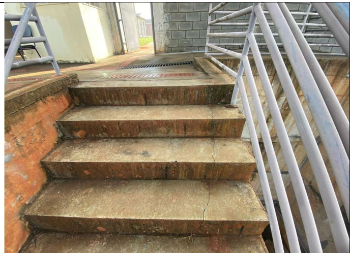
Foto 01 – Detalhamento de escada com possível recalque de solo do local
