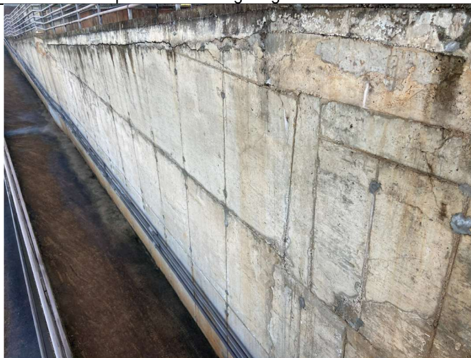
Foto 09 - Rampa com sinal de infiltração e alagamento após ligação da água
