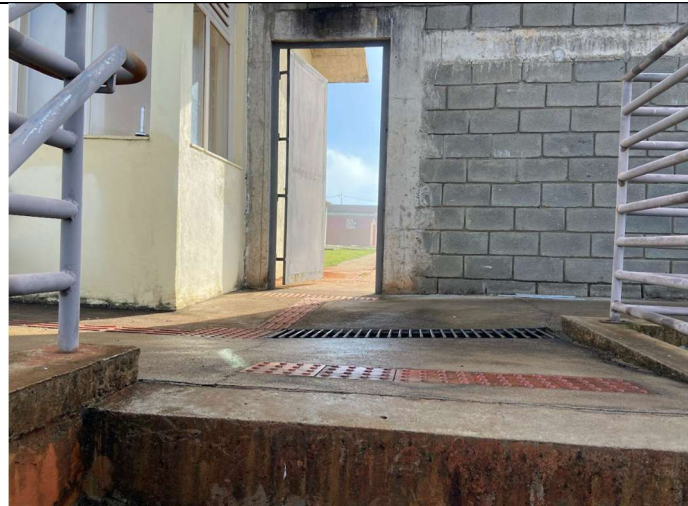
Foto 03 - Detalhamento de escada com possível recalque de solo do local
