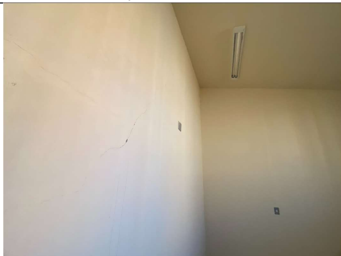
Foto 06 – Presença de trinca em banheiro PNE
