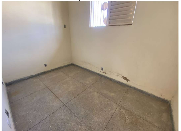
Foto 04 - Salas do administrativo com sinais de infiltração nas paredes
