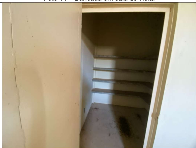
Foto 13 – Depósito de sala
