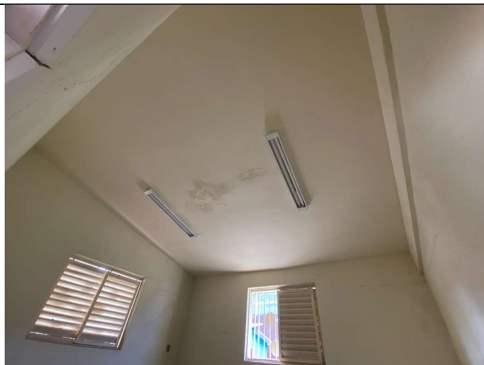
Foto 03 – Sinais de infiltração no teto de uma das salas de apoio
