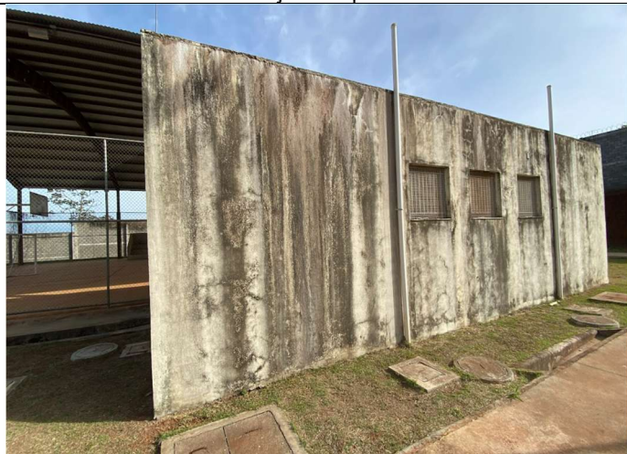
Foto 07 – Visão de fachada dos vestiários da quadra com muito sinal de infiltração
