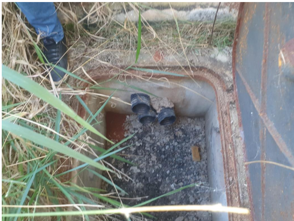
Imagem 1: caixa de passagem que alimenta a subestação.
