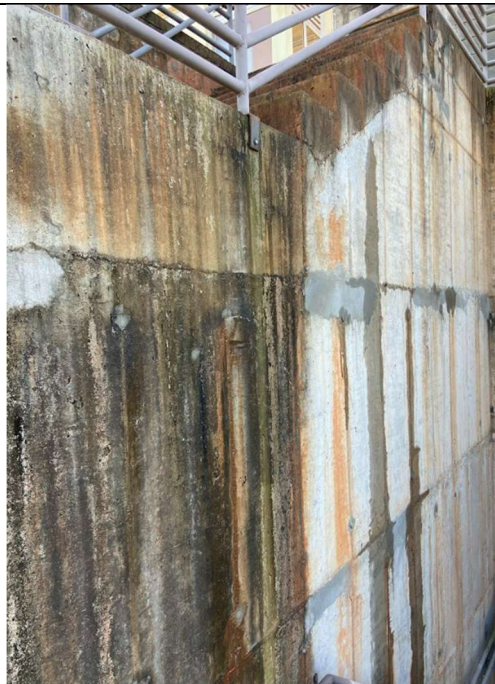
Foto 08 - Escada com sinal de infiltração e alagamento após ligação da água
