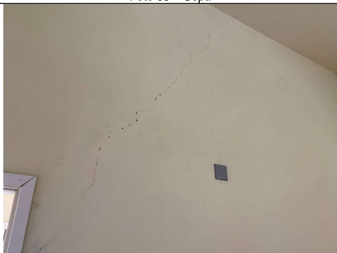
Foto 07 – Trinca em parede de uma das salas
