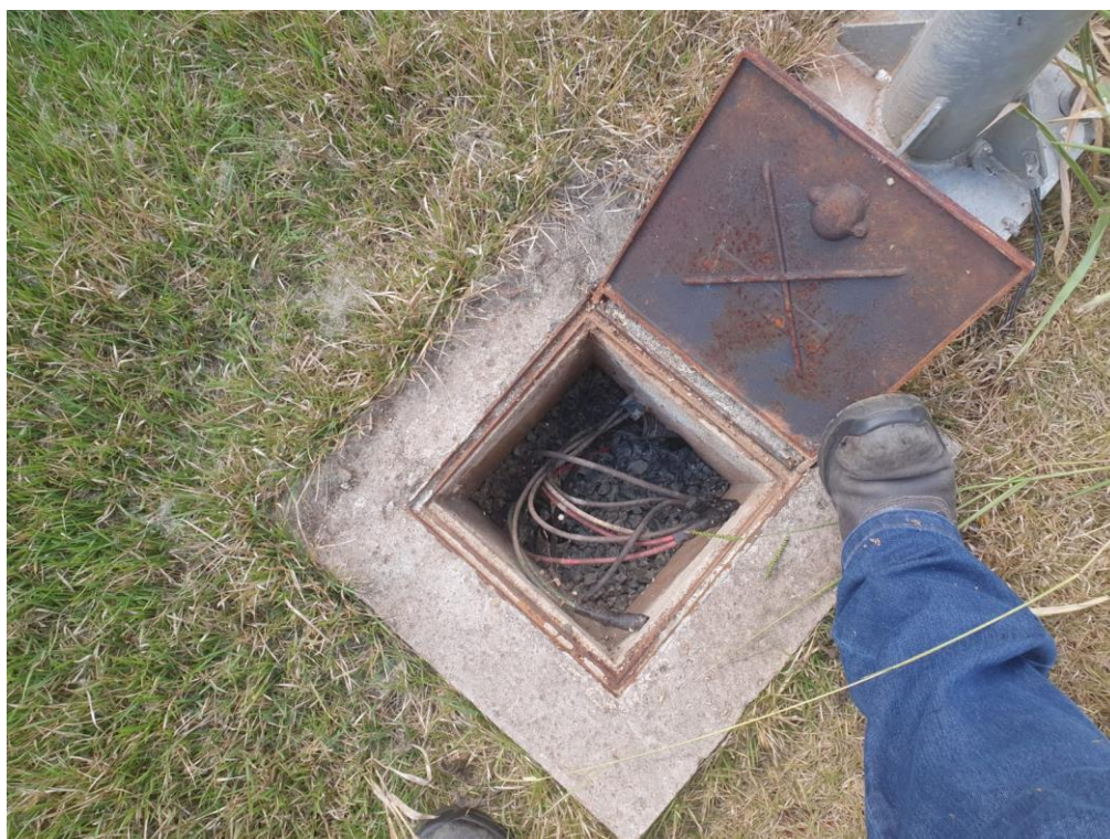
Imagem 8: caixa de passagem iluminação postes externos
