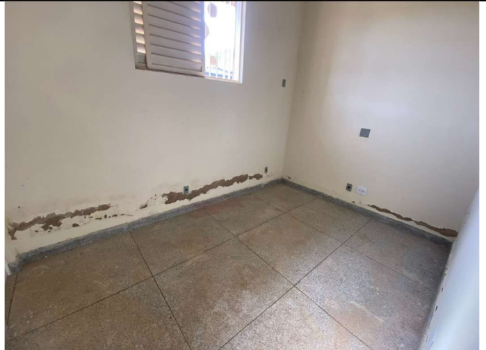
Foto 02 – Salas do administrativo com sinais de infiltração nas paredes
