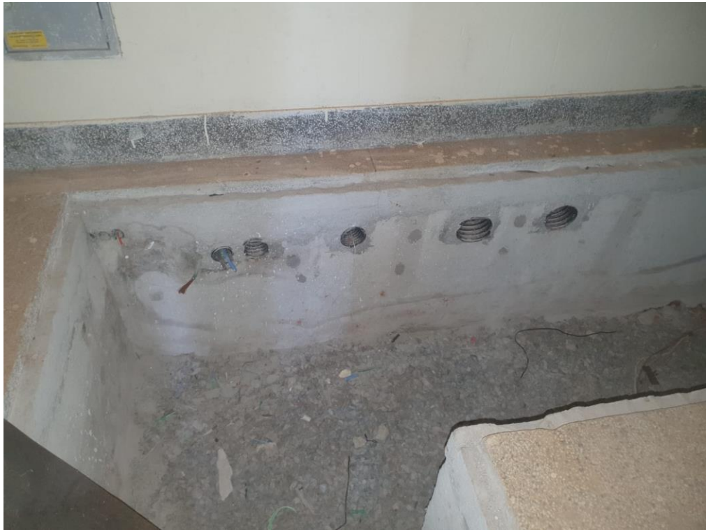
Imagem 4: local de entrada e saída da fiação da sala do gerador
