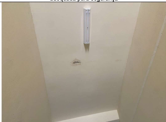
Foto 11 – Sinal de infiltração em teto do corredor
