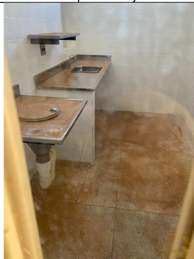
Foto 10 – Sala de "lavagem" sem acesso, pois porta emperrada
