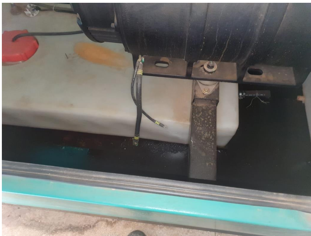
Imagem 3: local onde ficaria a bateria do gerador
