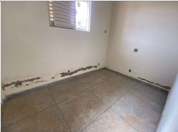
Foto 03 - Salas do administrativo com sinais de infiltração nas paredes
