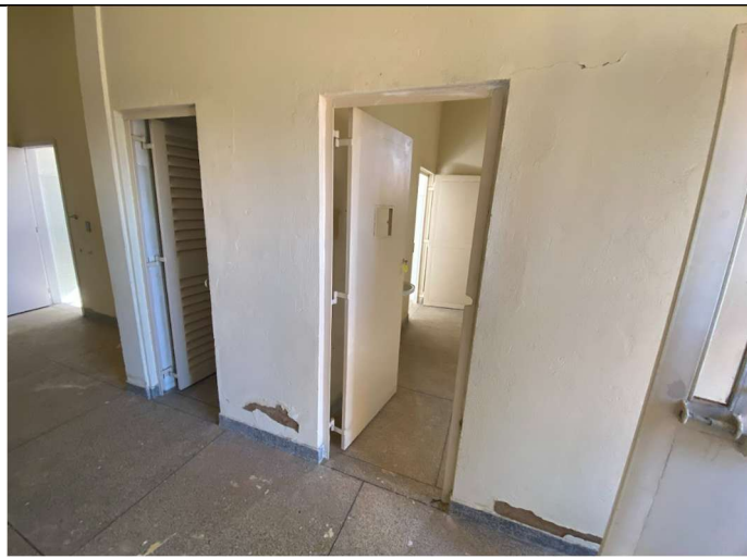
Foto 02 – Corredor com sinais de infiltração
