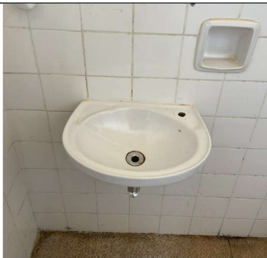
Foto 06 – Ausência de torneira na pia do banheiro
