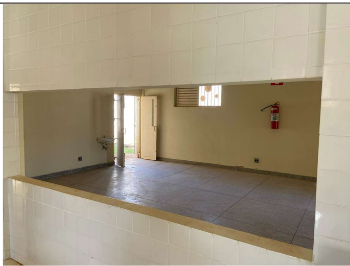
Foto 09 – Espaço de passagem de comida a ser instalada grade de proteção
