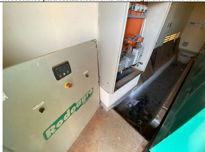
Foto 01 – Prédio Casa Gerador sem cabeamento
