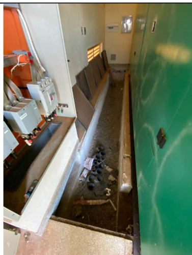
Foto 02 – Prédio Casa Gerador sem cabeamento
