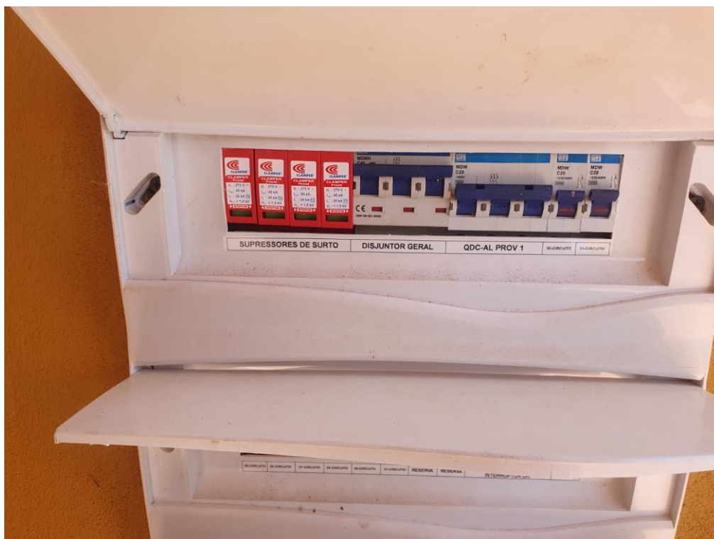
Imagem 9: quadro de distribuição interno próximo ao alojamentos
