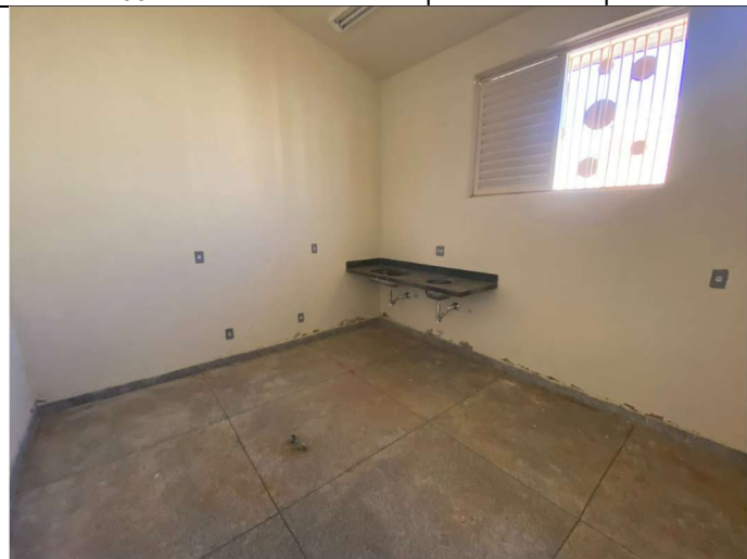
Foto 05 – Presença de sinais de infiltração em sala
