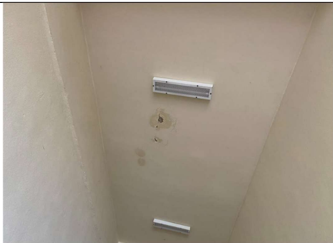
Foto 15 – Pequeno sinal de infiltração no teto
