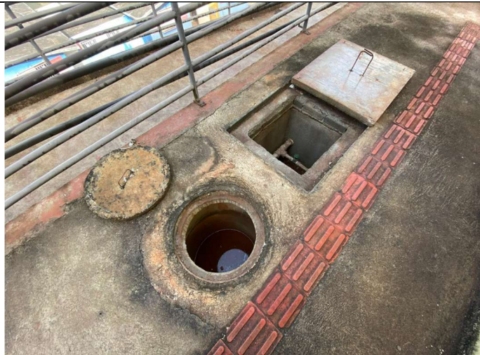
Foto 04 – P.V. próximo a rampa com entupimento após ligação de água
