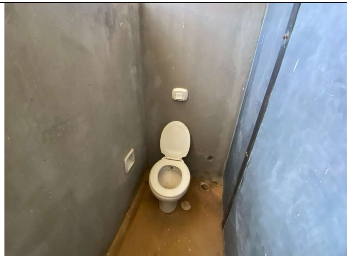
Foto 05 – Vaso sanitário exposto
