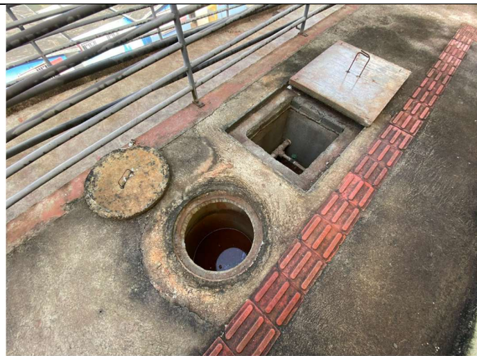
Foto 05 - P.V. próximo a rampa com entupimento após ligação de água
