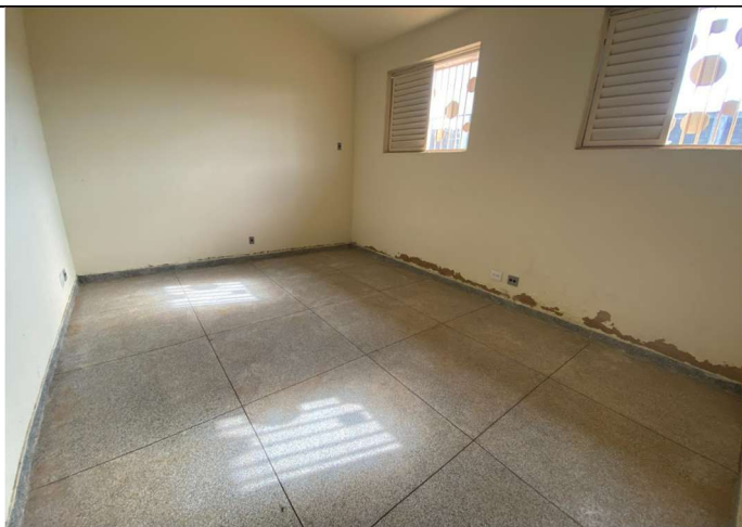
Foto 08 - Salas do administrativo com sinais de infiltração nas paredes
