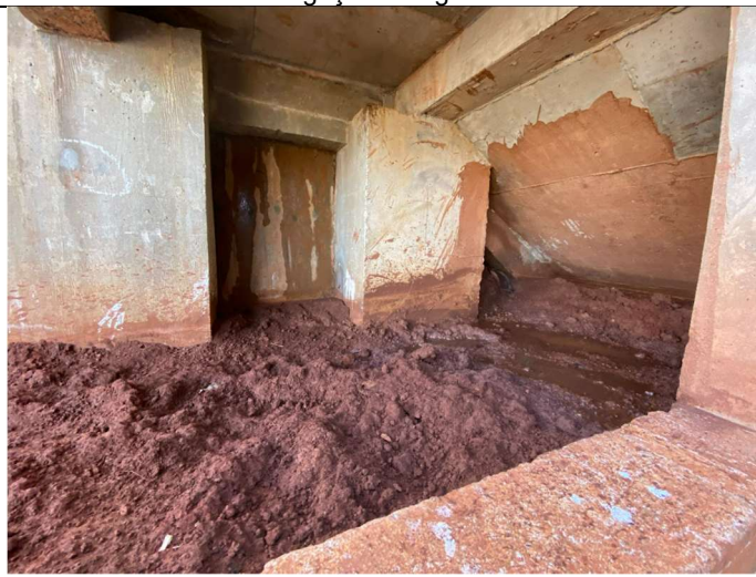
Foto 10 - Rampa com sinal de infiltração e alagamento após ligação da água
