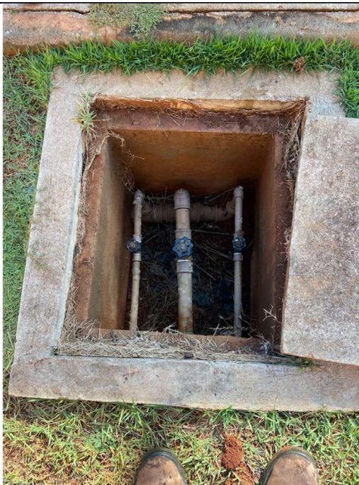
Foto 07 – Registros que não foram possíveis de serem acionados para tentar desligar água da ala do refeitório
