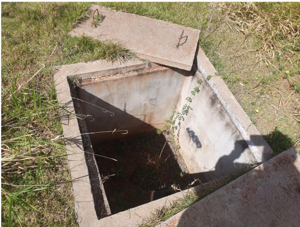
Imagem 6: caixa de passagem entre o QGBT e quadros de distribuição
